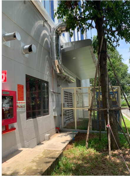
Hình 3.13 Máy phát điện dự phòng cho Nhà xưởng số 1, Lô I-3B-1
