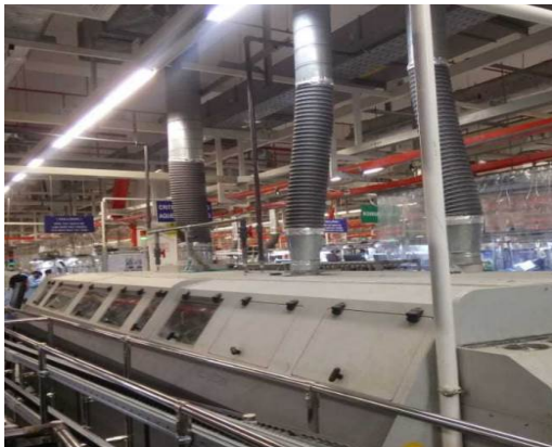
Hệ thống chụp hút hơi dung môi
