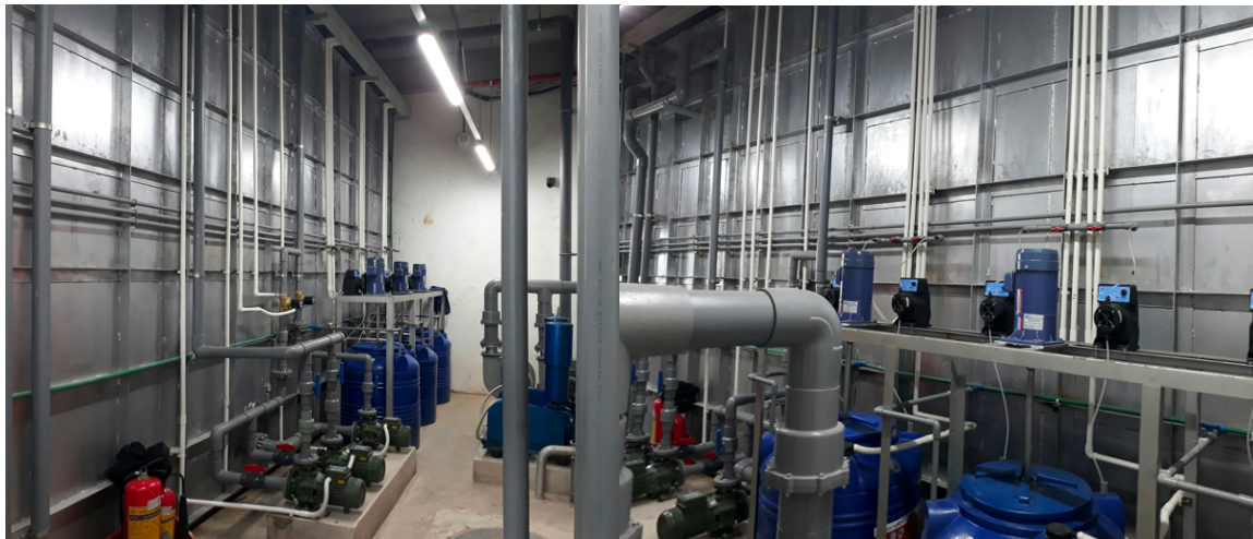
Hình 3.6 Hình ảnh về hệ thống xử lý nước thải, công suất 105 m 3 /ngày
