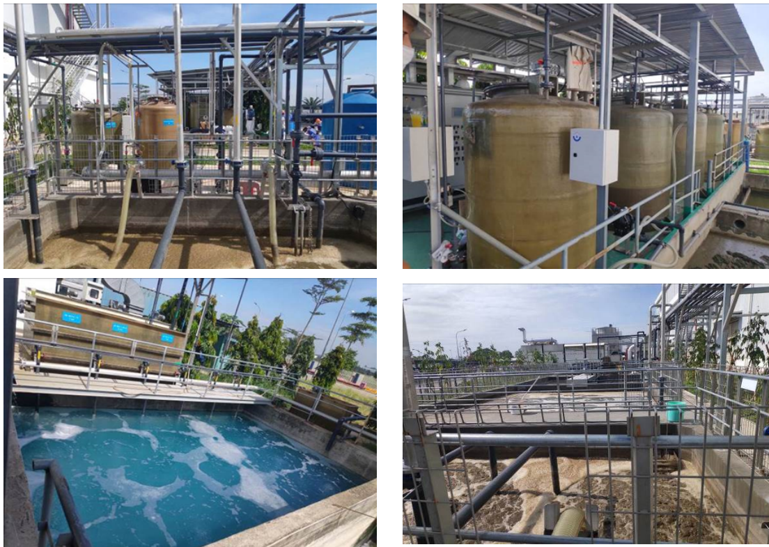
Hình 3.3 Hình ảnh về hệ thống xử lý nước thải, công suất 600 m 3 /ngày
