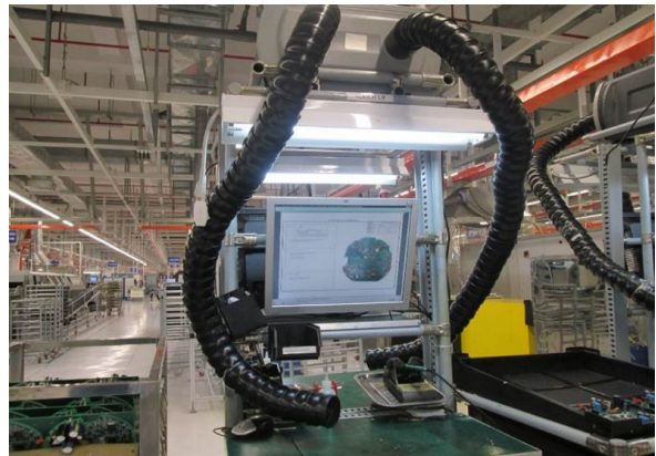
Hệ thống hút hơi hàn cục bộ
