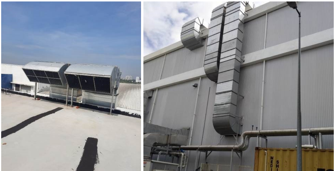
Hình 3.12 Ống khói thải Khu nhà xưởng B2
