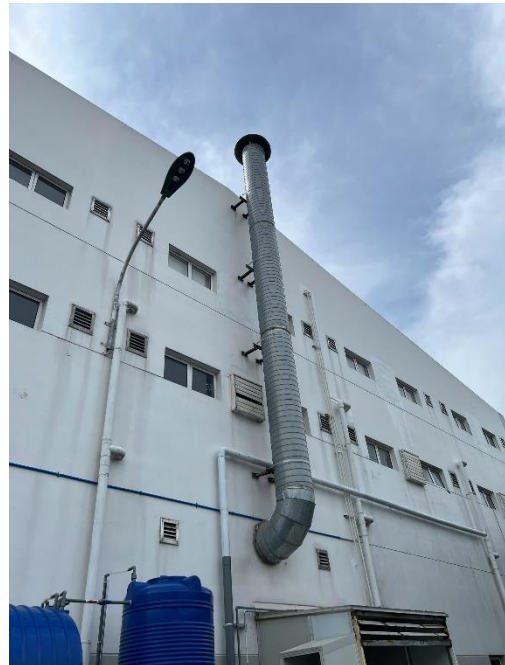
Ống thoát khí thải lò sấy
