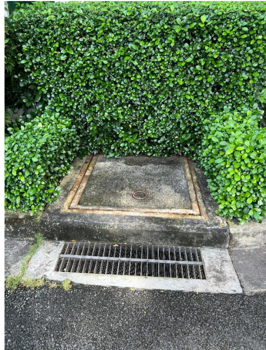
Hố ga thu gom nước mưa chảy tràn
