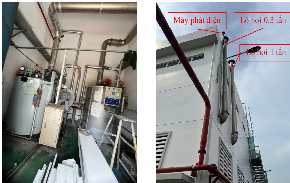
Hình 3. 16. Hình ảnh 02 hệ thống thu gom và thoát khí thải lò hơi của cơ sở 3.2. Công trình, biện pháp lưu giữ, xử lý chất thải rắn thông thường:
