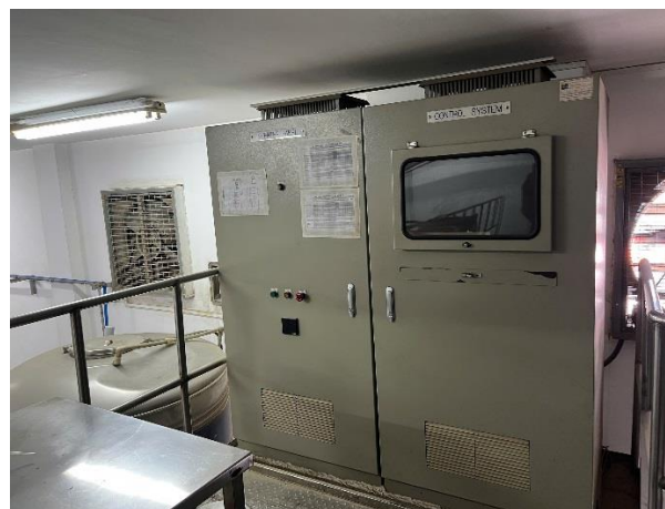
Hệ thống điều khiển quá trình lên men
