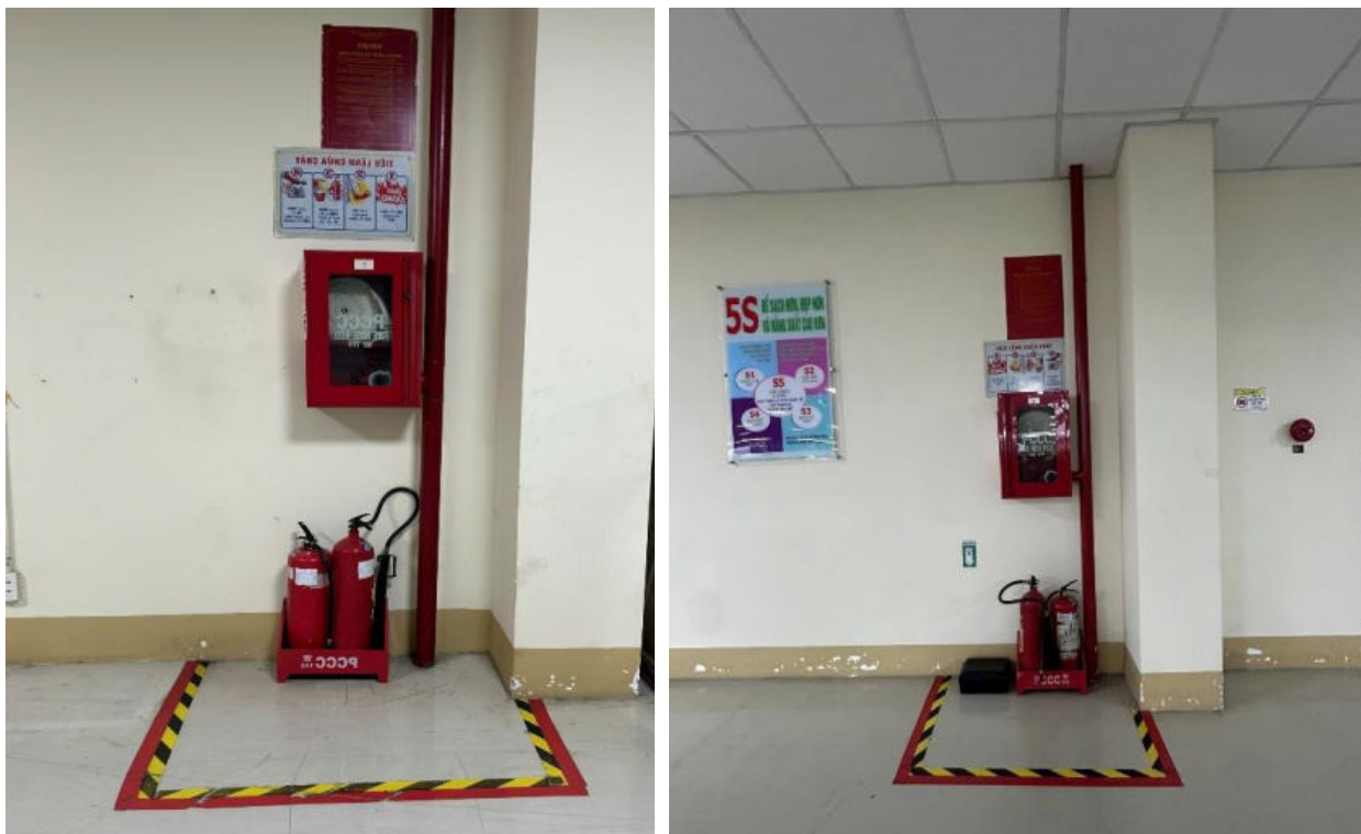
Hình 3.9 Hệ thống PCCC tại cơ sở
