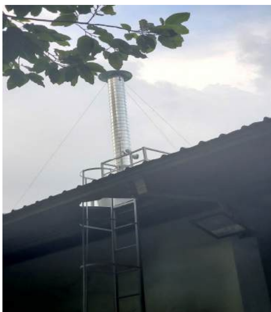
c. Ống thoát khí thải chung từ công đoạn hàn
