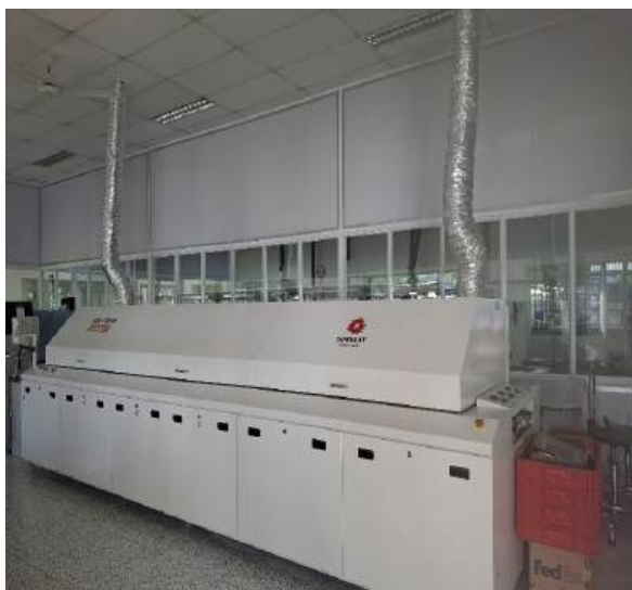
a. Đường ống thu gom khí thải từ lò hàn tự động
