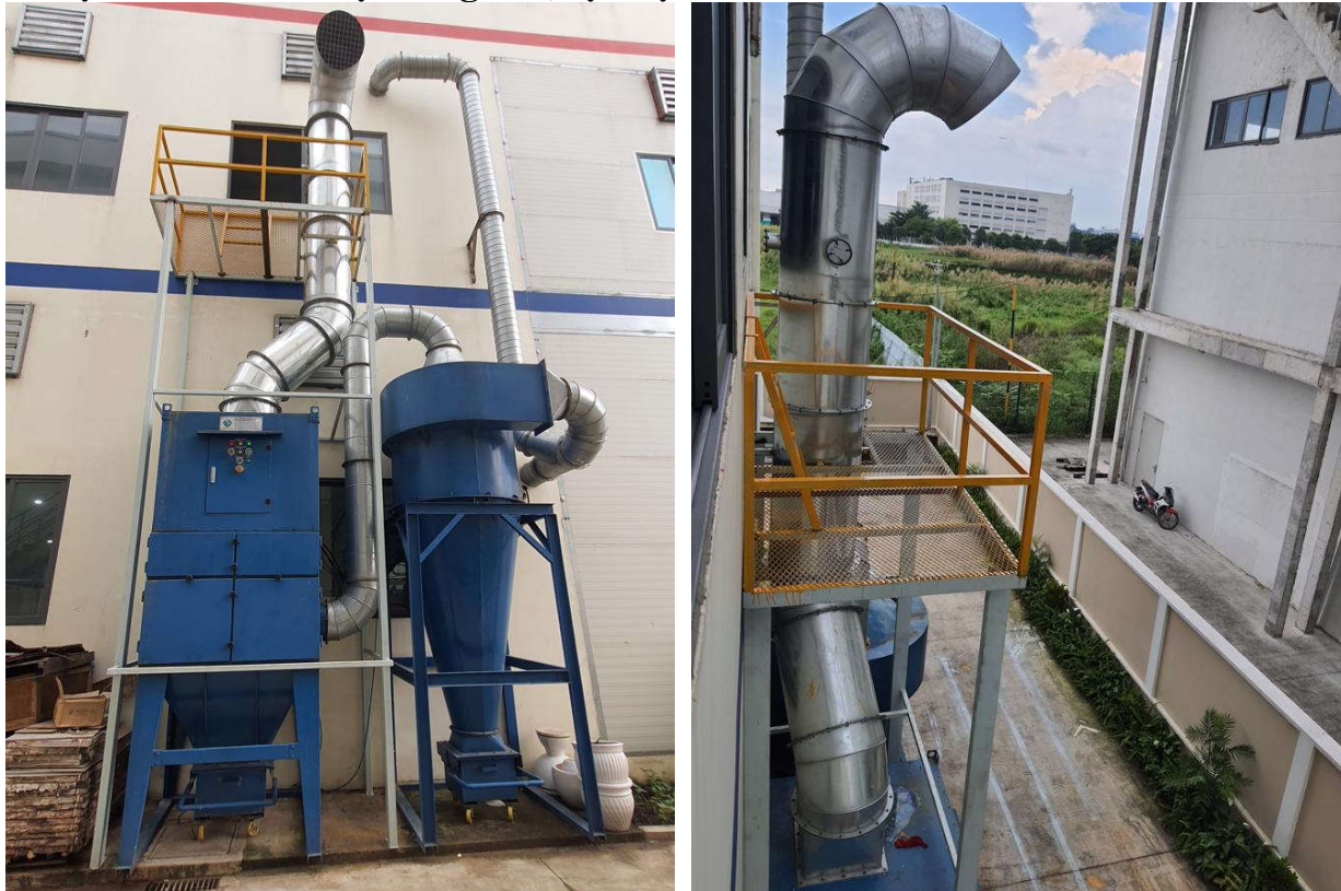
Hình III-11: Hệ thống hút và lọc bụi kim loại cho xưởng Sintering
