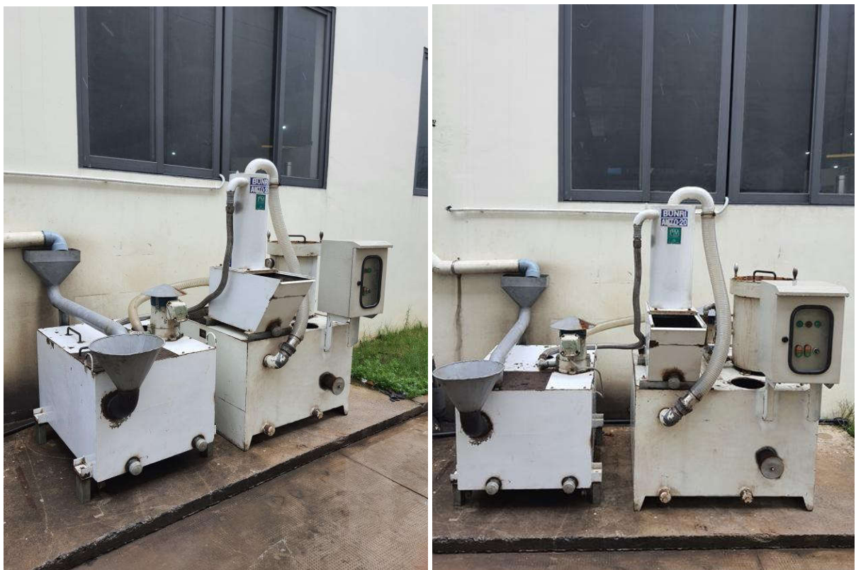
Hình III-10: Hình ảnh hệ thống xử lý nước làm mát để tái sử dụng.
