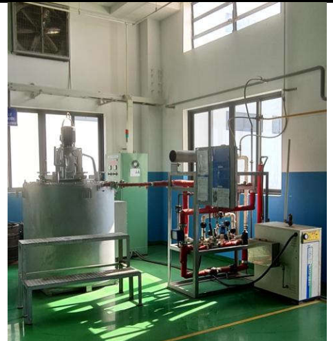
Hình I-20: Thiết bị xử lý hơi nước
