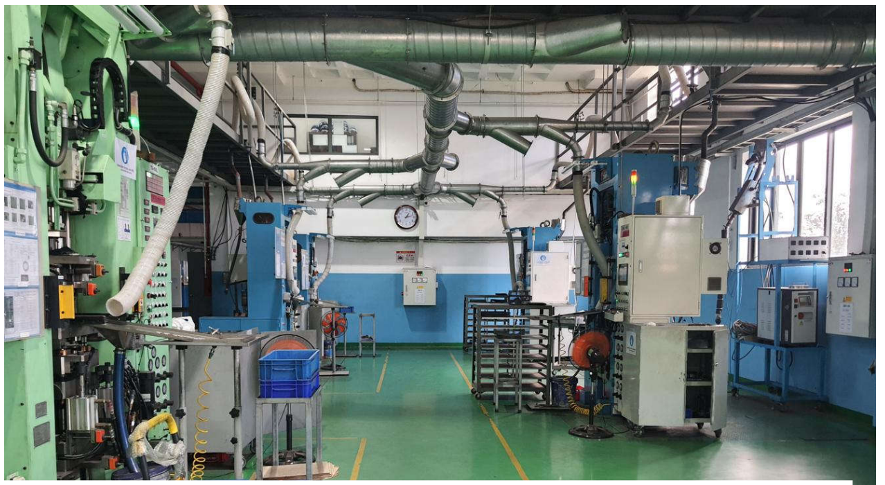
Hình III-12: Đường ống hút bụi của hệ thống hút và lọc bụi
