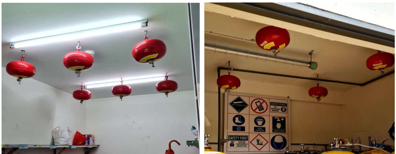
Hình I-29: Bình chữa cháy tự động tại dự án
