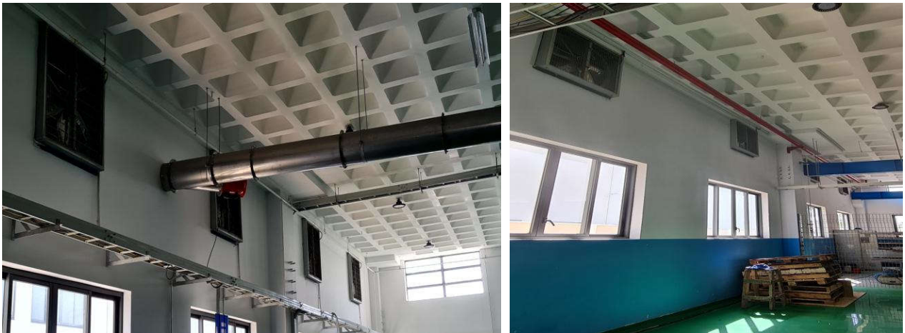
Hình III-19: Hệ thống ống thoát khí nóng và quạt điều hòa không khí tại nhà xưởng
