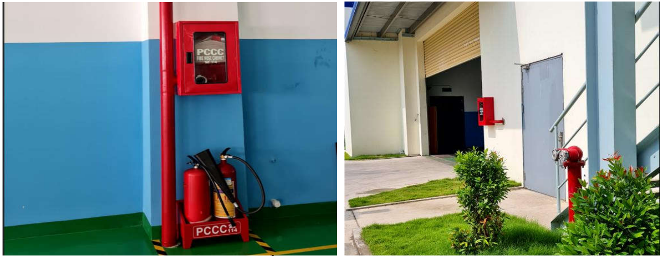
Hình I-30: Hệ thống chữa cháy họng nước tại dự án
