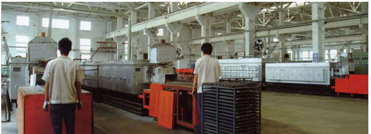
Hình III-23: Hình ảnh xả khí nóng của lò thiêu kết tại Đài Loan, Hàn Quốc
