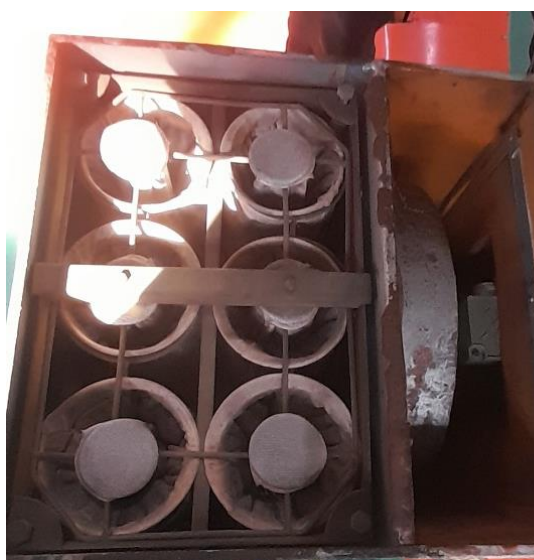
Hệ thống lọc túi vải bên trong máy hút bụi
