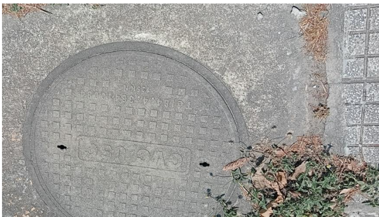
Hình 3.3 Hố gas đầu nối nước mưa với HT thoát nước mưa khu CNC.
