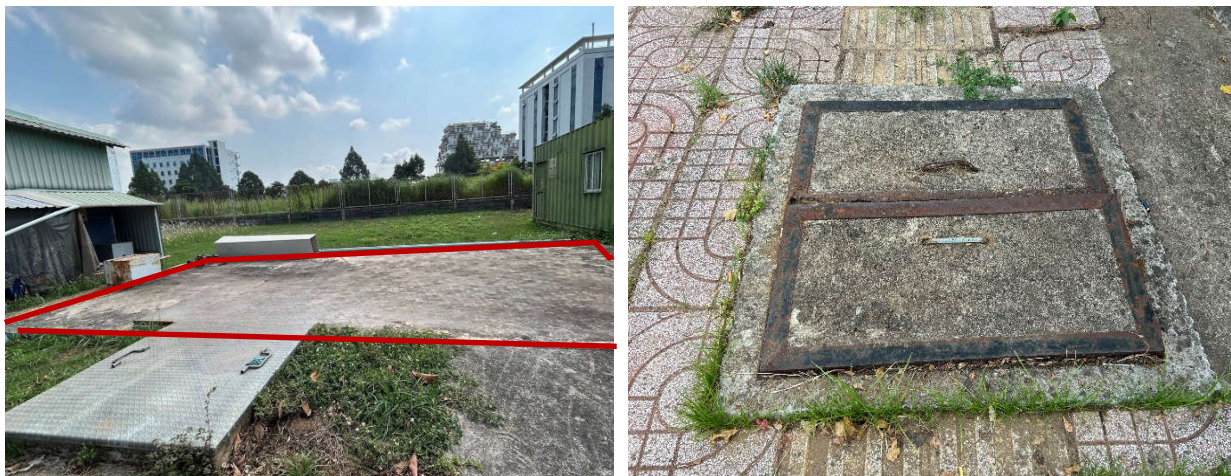
Hình 4.4 Hình ảnh bể chứa nước thải và hố ga đấu nối nước thải với mạng lưới thu gom, thoát nước thải với KCNC của dự án.
